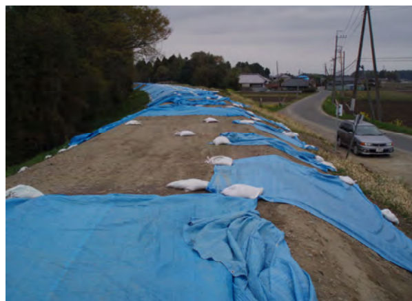
写真 2.1.2-5 支川里川堤防天端の沈下・亀裂
