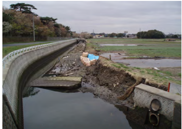
写真 2.1.2-2 豊岡第一樋管・支川左岸護岸の崩壊
