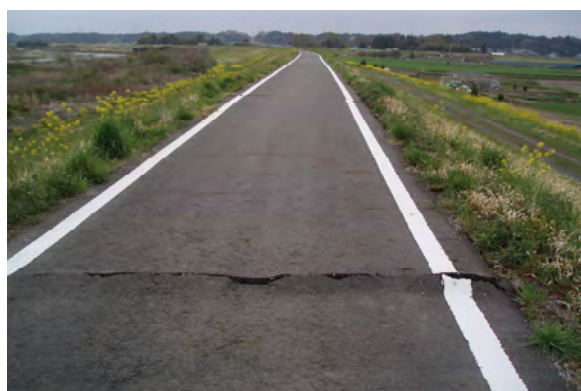
写真 2.1.2-6 山田川堤防天端の横断亀裂
