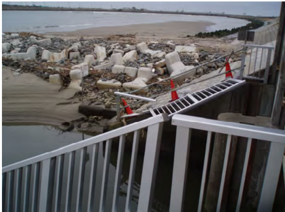
写真 2.1.2-1 豊岡第一樋管水門の手すり損壊
