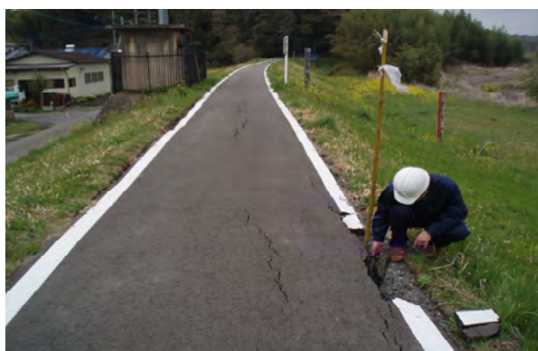
写真 2.1.2-7 山田川堤防天端の縦断亀裂
