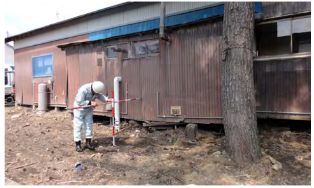
写真 2.1.1-8 家屋の壁の氾濫痕跡 H=90cm
