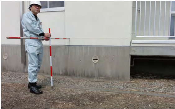
写真 2.1.1-9 家屋の壁の氾濫痕跡 H=90cm
