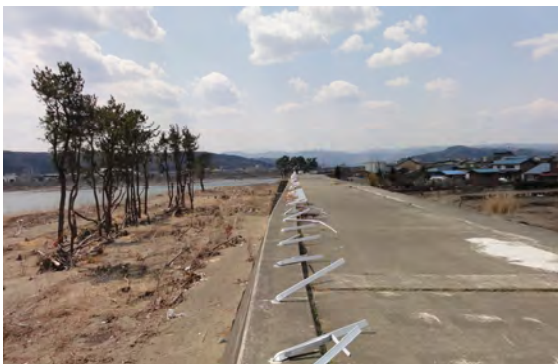
写真 2.1.1-11 護岸欄干の倒壊と残存防潮林
