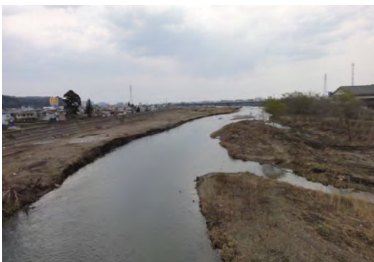
写真 2.1.1-15 低水路のり面の垂直洗屈
