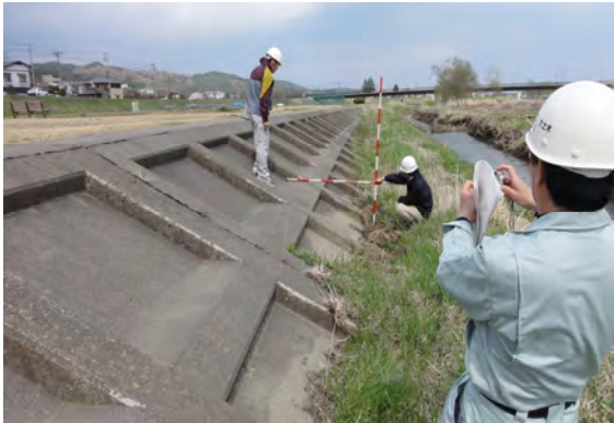
写真 2.1.1-17 堤防のり面下段に砂の痕跡有り
