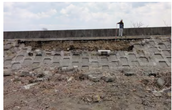
写真 2.1.1-12 防潮堤防裏のりの破壊
