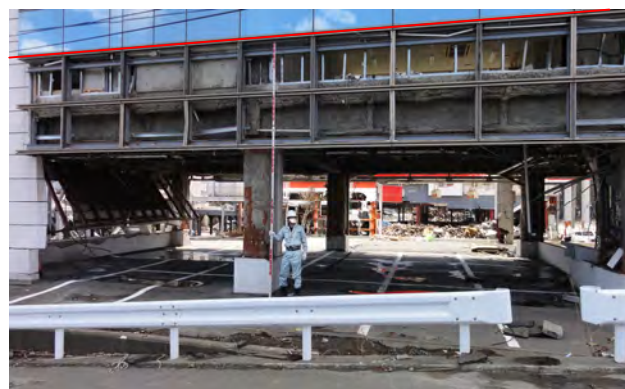
写真 2.1.7-1 事業所ビル壁面の損壊
