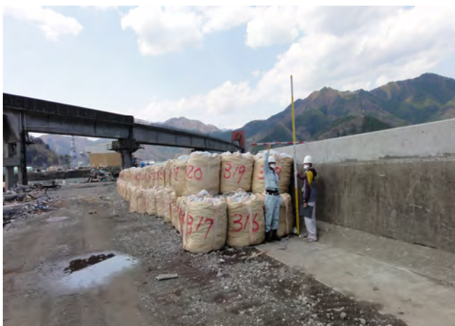
写真 2.1.7-2 堤防の崩壊箇所より上流を望む
