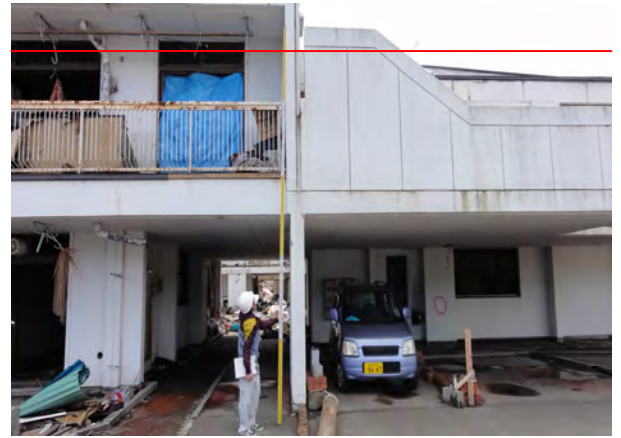
写真 2.1.7-1 3階建ての住居ビルの損壊
