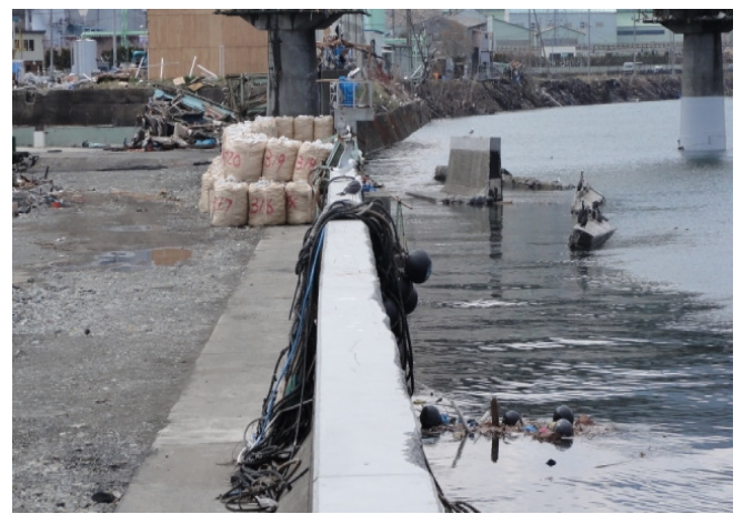
写真 2.1.7-2 右岸コンクリート堤防の崩壊
