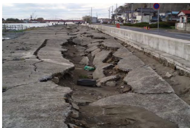
写真 2.1.1-3 湊大橋下流左岸のエプロンの崩壊
