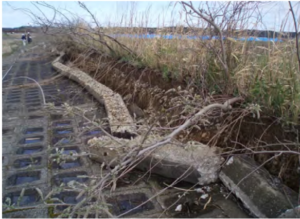
写真 2.1.1-7 涸沼川表のりコンクリート枠の崩落
