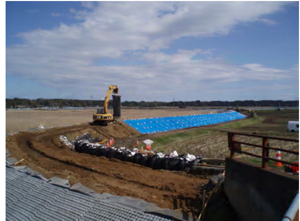
写真 2.1.1-8 涸沼川堤防陥没と応急復旧工事
