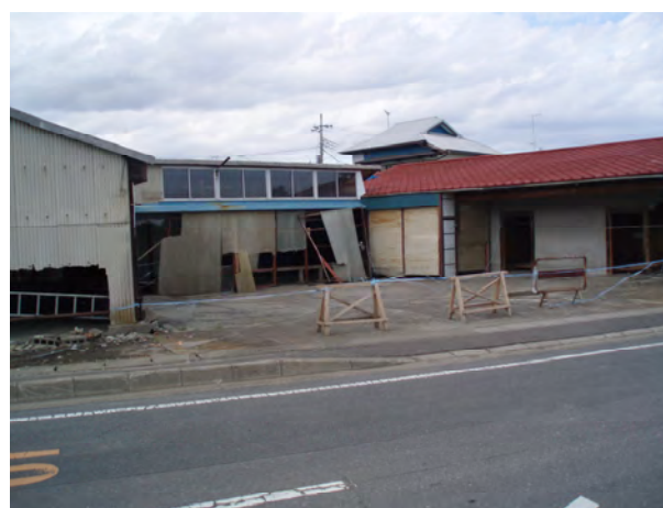
写真 2.1.1-2 津波による浸水で家屋・工場の損壊
