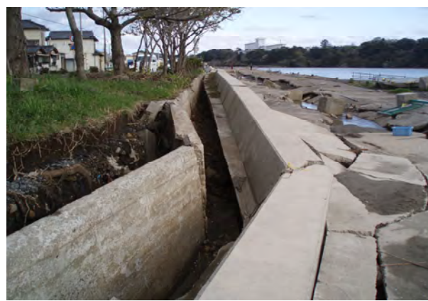
写真 2.1.1-4 湊大橋下流左岸の護岸の崩壊
