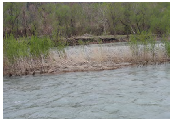
写真 2.1.2-7 右岸側低水路のり面の侵食
