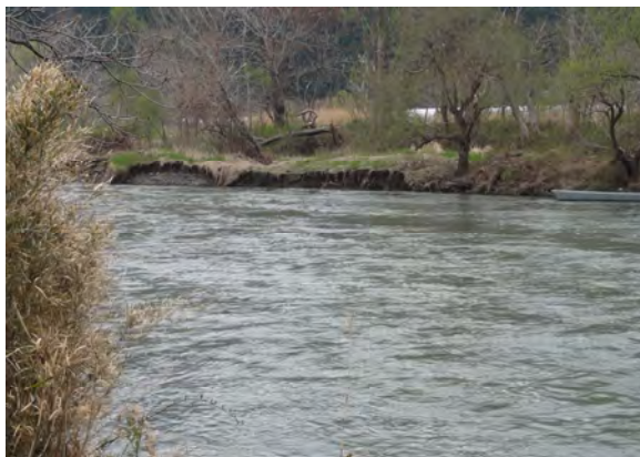
写真 2.1.2-5 右岸側低水路のり面の侵食 地の水田は堤防によって守られ浸水は見られない。
