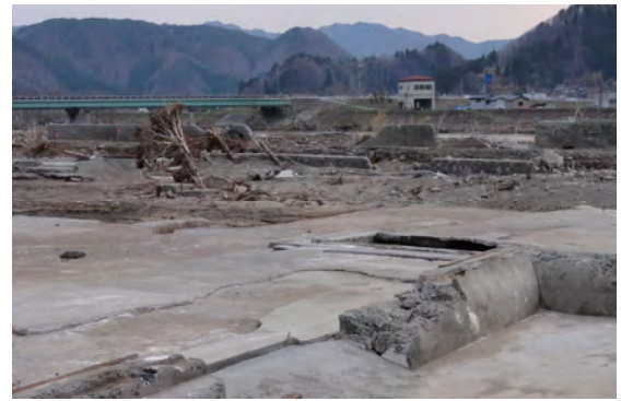
写真 2.1.2-3 堤防・アバットの損壊
