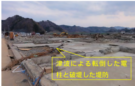
写真 2.1.2-2 右岸堤防の破堤方向に転倒する電柱
