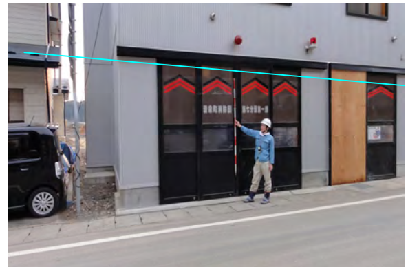
写真 2.1.2-4 消防団建物の津波痕跡 H=2.5m
