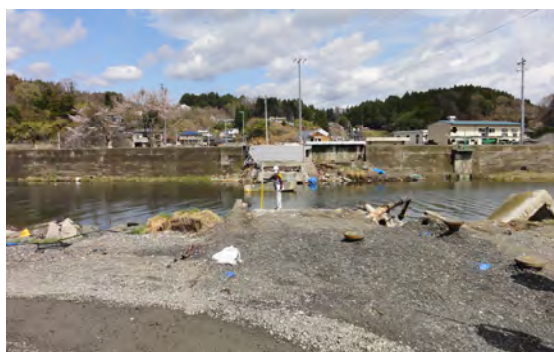
写真 2.1.6-5 道路橋の落橋跡
