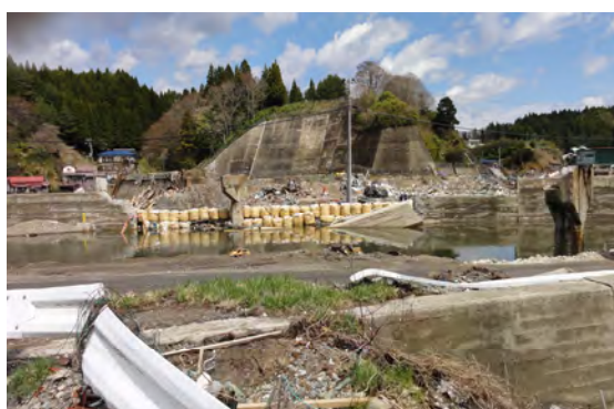
写真 2.1.6-7 護岸と橋台はともに損壊
