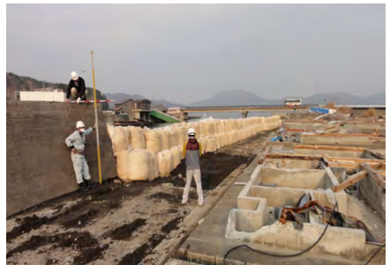
写真 2.1.5-2 右岸崩壊・護岸高 H=2.2m
