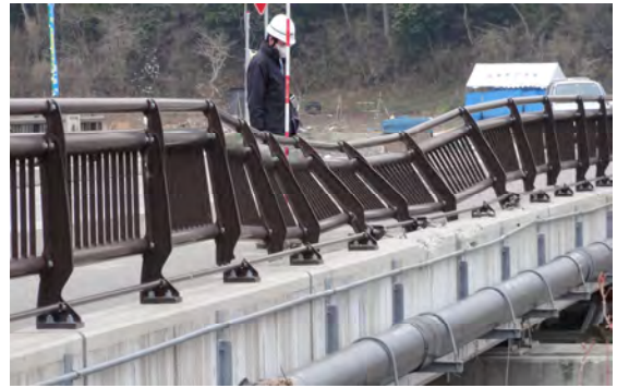
写真 2.1.5-8 北っ子橋・欄干の損壊
