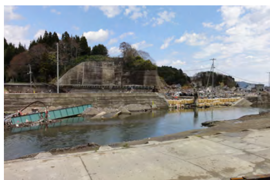
写真 2.1.6-8 落橋した J R 山田線の鉄道橋
